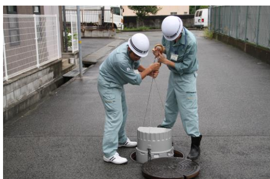
汚水幹線での監視（自動採水器設置）
