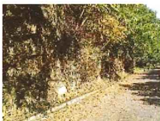
落石防護ネットが古いと指摘あり。確かに錆びている。
