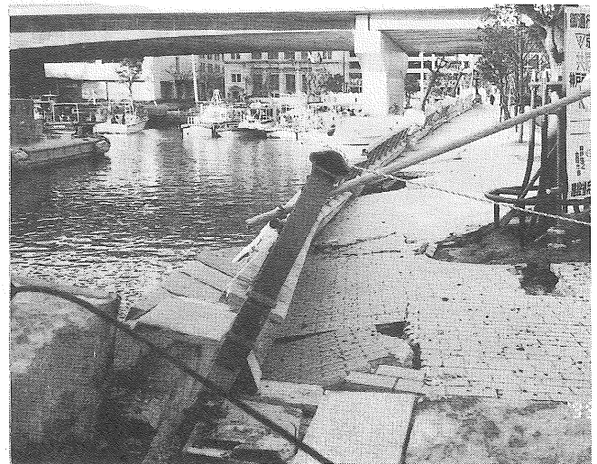
京橋付近の被害状況（中央区新港町）
