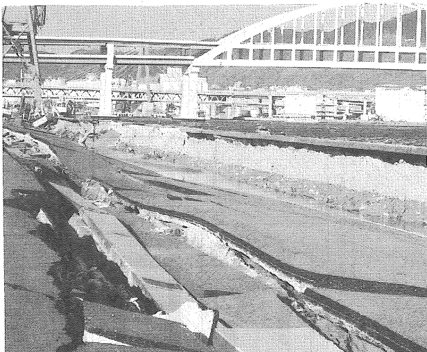
L岸壁の破損状況（六甲アイランド）
