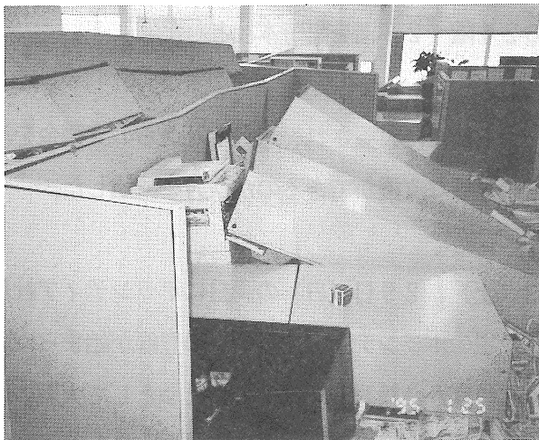
事務スペースの地震後の状況と改修状況
