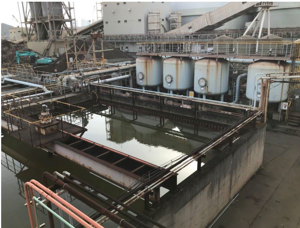
写真 4. 4-1 平成 30 年度における工事排水処理設備の設置状況
