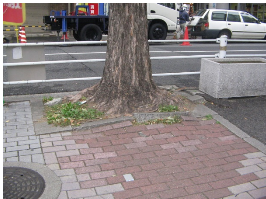
写真 1-7 根上がりで持ち上がった舗装
