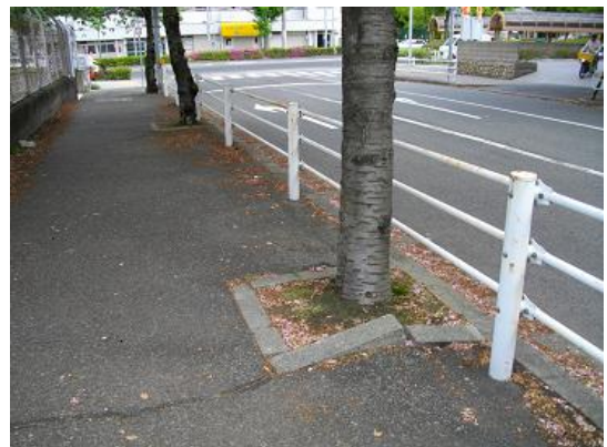
写真 1-8 根上がりで持ち上がった舗装
