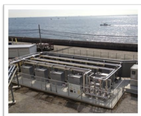
バイオガス発電
