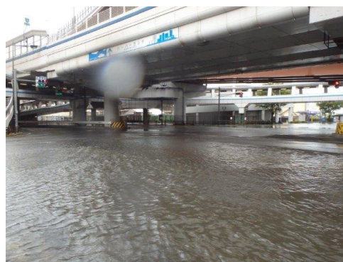
台風による道路冠水被害
