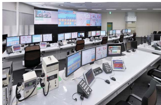
消防管制室の状況
