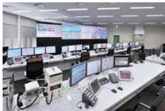
消防管制システム
