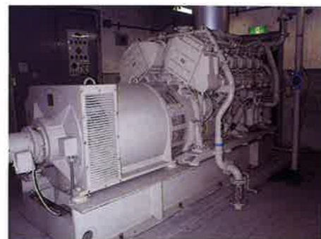
自家用発電機
