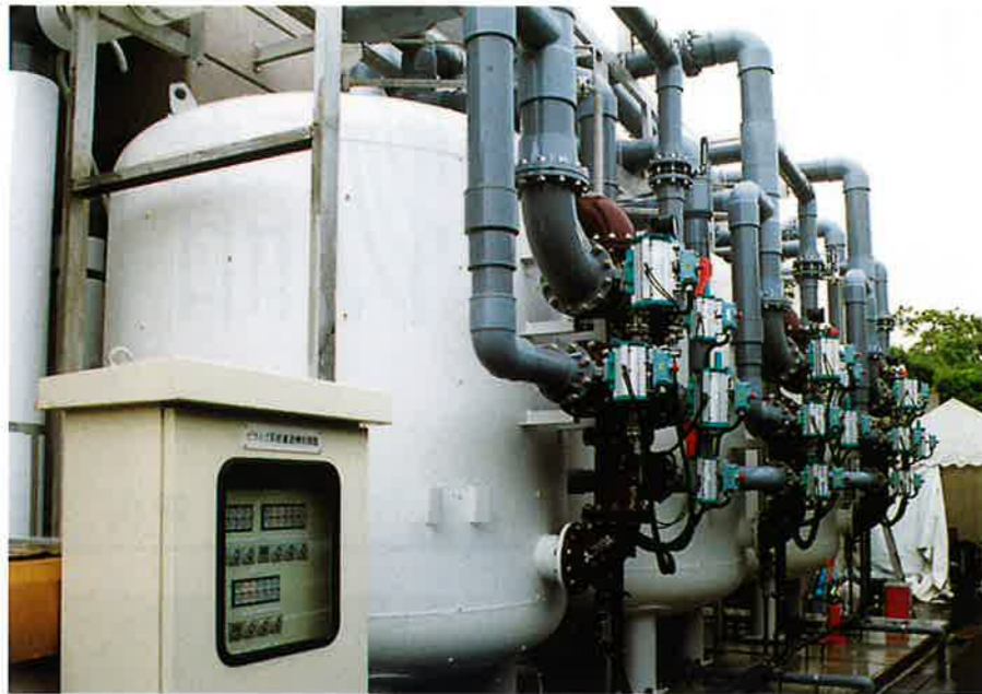
ろ過タンク。蓋を開けてバクテリアの濃縮液を入れた。
