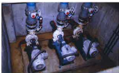
波の大水槽 循環ポンプ
