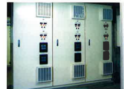
波の大水槽 インバーター盤
