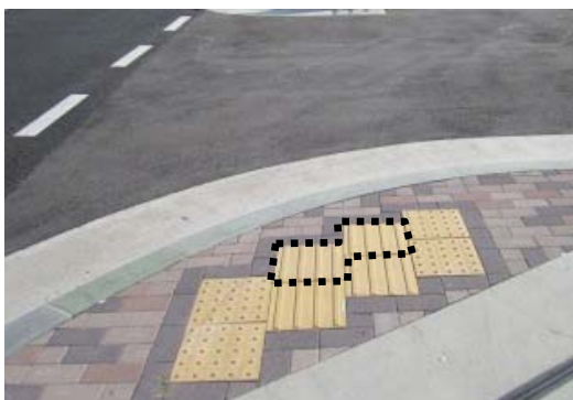
車道横断部は注意喚起のための点状ブロックとすべきところ線状ブロックが設置されている。(須磨区)
