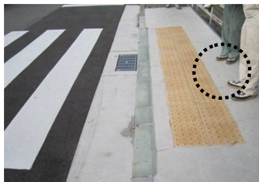
横断方向を示す線状ブロックが設置されていない。また、構造上やむを得ずコンクリート床版内にブロックを設置したが輝度比(2.0程度)が確保されていない。(北区)
