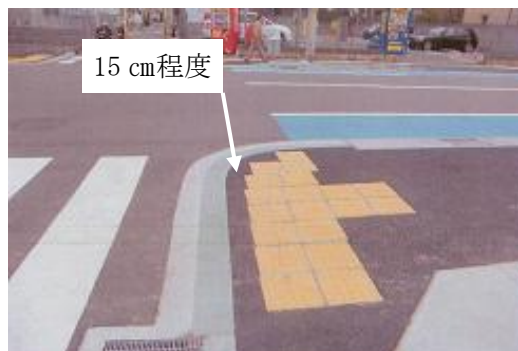
車道横断部の歩道巻き込み部は、縁石ブロック背面より30cm控えて設置すべきところ15cm程度としている。(東灘区)
