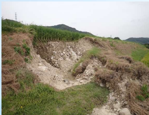
農地の法面崩壊
