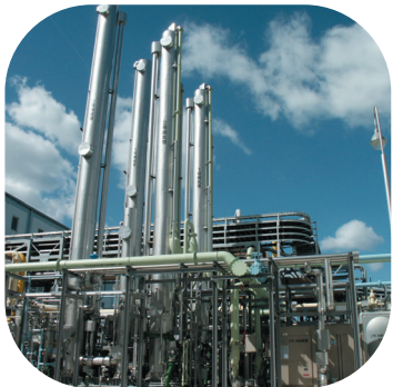
▲バイオガス精製設備
