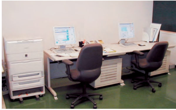
中央監視室 Central Control Room
