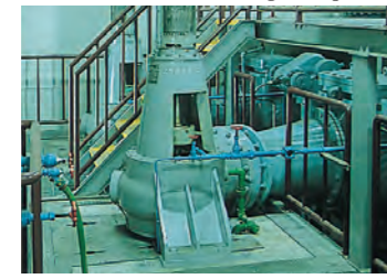
▲汚水ポンプ室
