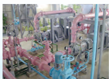
▲汚泥圧送ポンプ
