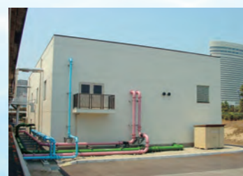
▲汚泥圧送施設
