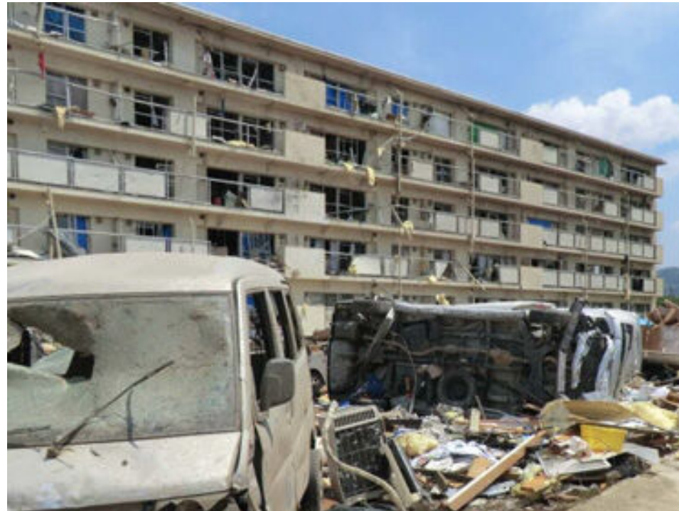
竜巻による被害（平成24年5月6日：つくば市） （気象庁ホームページより）
