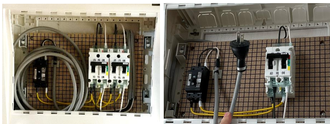
写真1 接続ケーブル一体型分電盤内の状況
