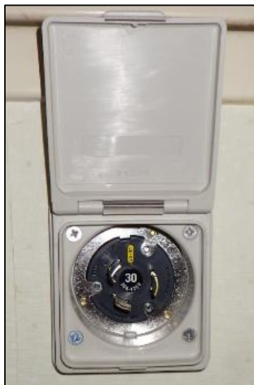
写真1 外部給電取込口
