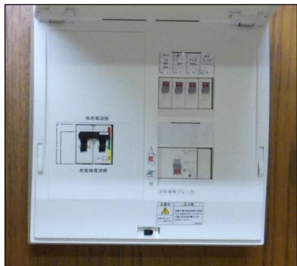
写真2 手動切替器（新設分電盤）
