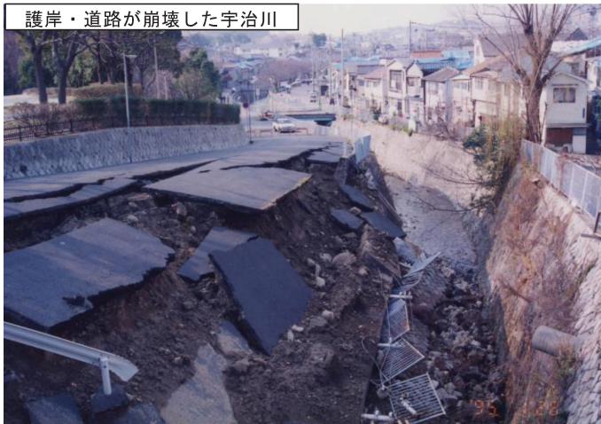
護岸・道路が崩壊した宇治川
