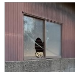
窓が割れた管理不全空家
