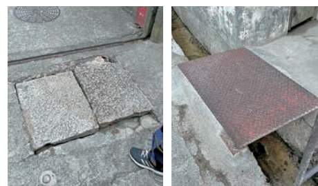
流された石のふたと鉄板
