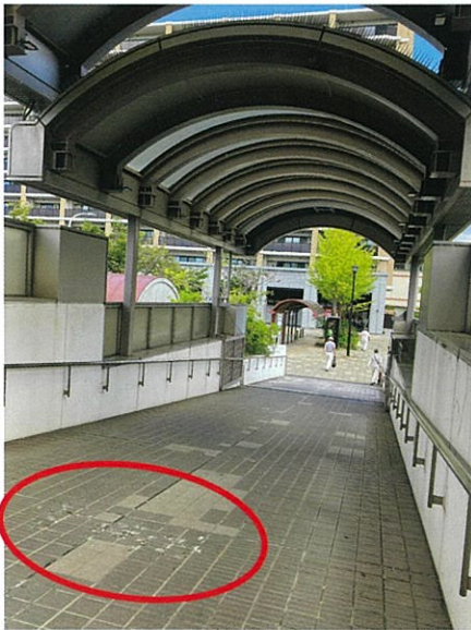
ハトの糞で汚れる通路
