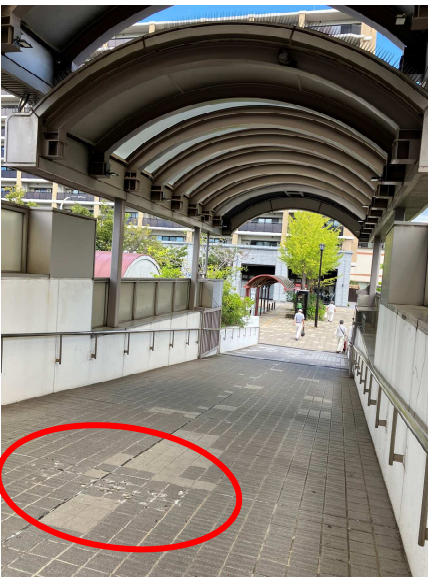
ハトの糞で汚れる通路
