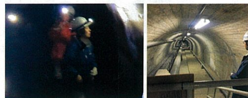
▲改修のため60年ぶりに水を止めている4 拡送水トンネルを会派の有志で視察。市民の水は六甲山系の中を通る送水トンネルに支えられています。
