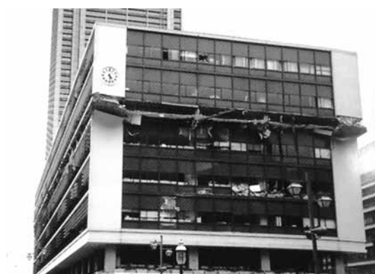
被害を受けた神戸市役所2号館
