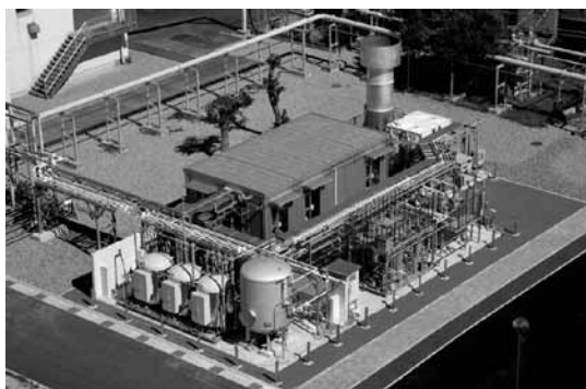
写真8 都市ガス化設備
