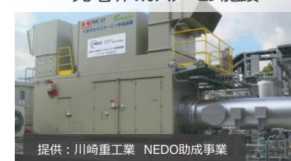
発電所のガスタービン施設
